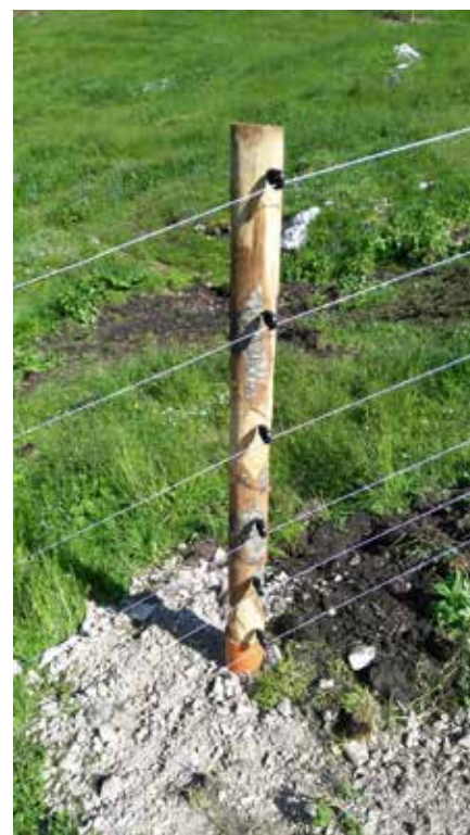
Fig. 4 - Particolare della messa a dimora del palo utilizzando dei tubi di plastica fissati con il cemento (D. Asson Archivio Servizio Foreste e fauna).
