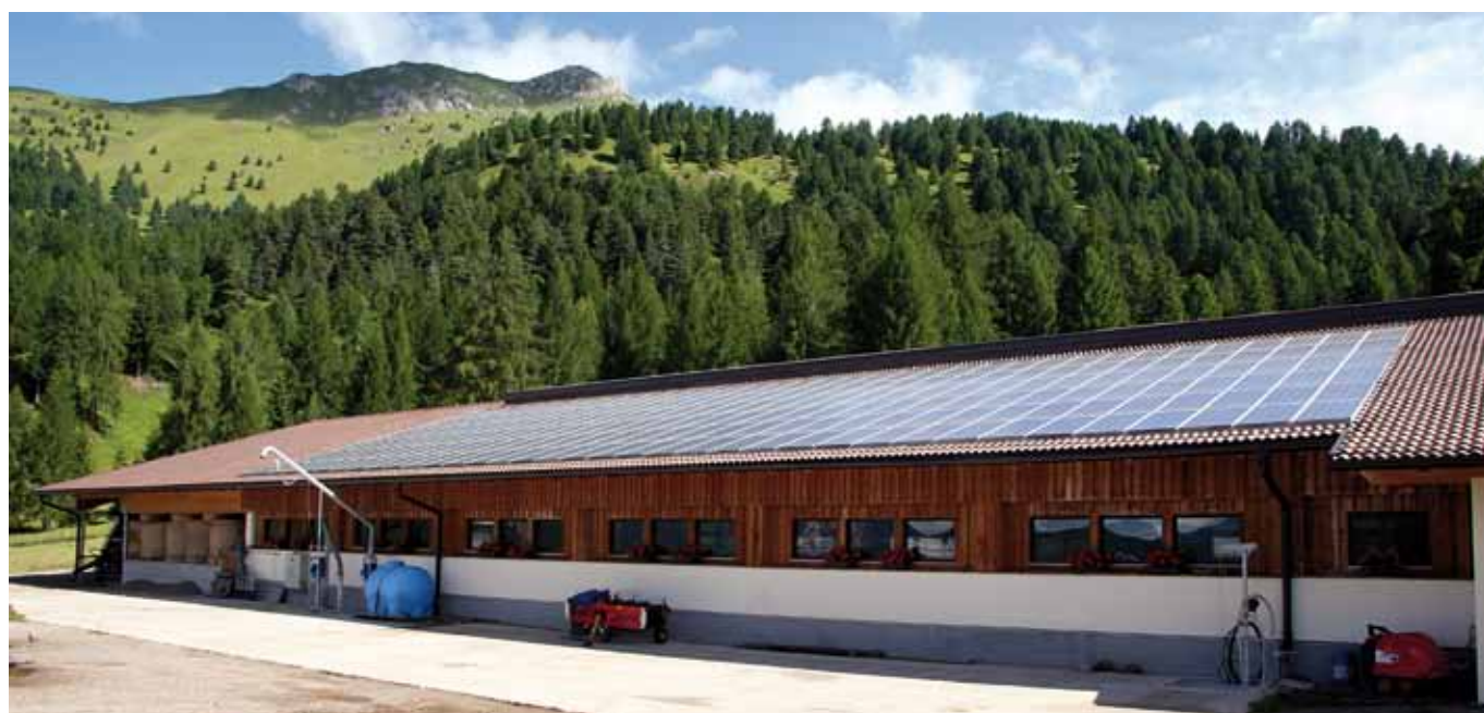
Esempio di pannelli fotovoltaici applicati sul tetto di una stalla in val di Fiemme
